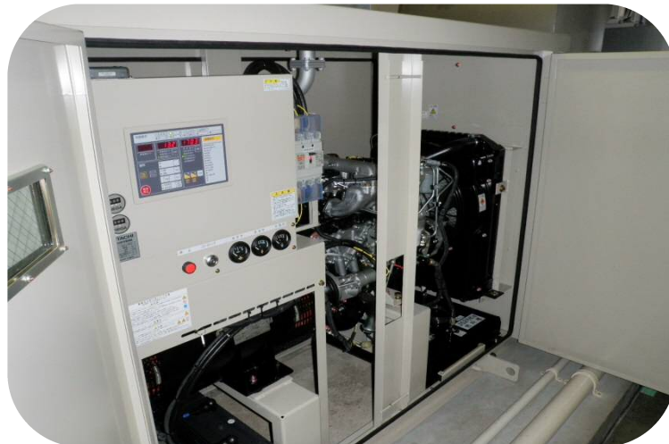
《 滝沢浄水場非常用発電機 》
